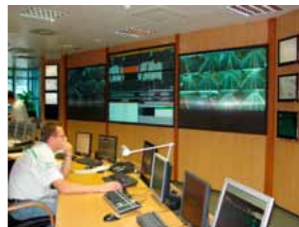
Salle de contrôle du trafic sur un réseau autoroutier en Slovénie
